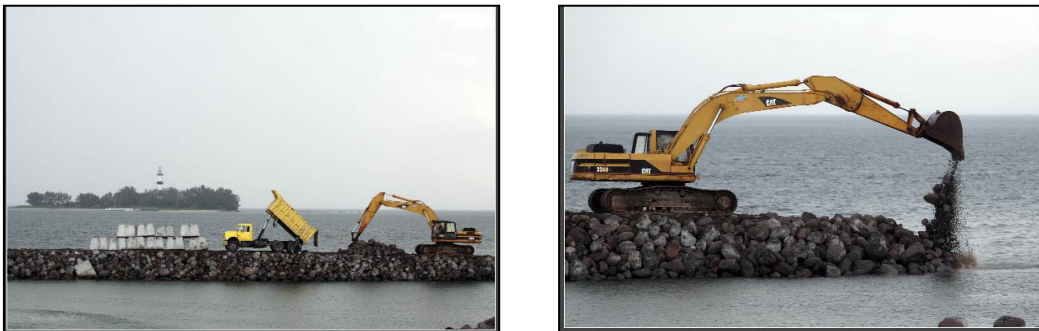
FIGURA 3. EJEMPLO DE OBRAS DE PROTECCIÓN COSTERA EN EL ÁREA DE ESTUDIO.
