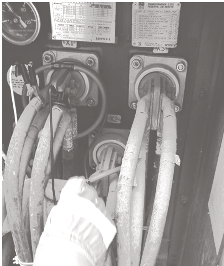
Figura 2. Conexión del analizador portátil de redes en el transformador para alumbrado.
