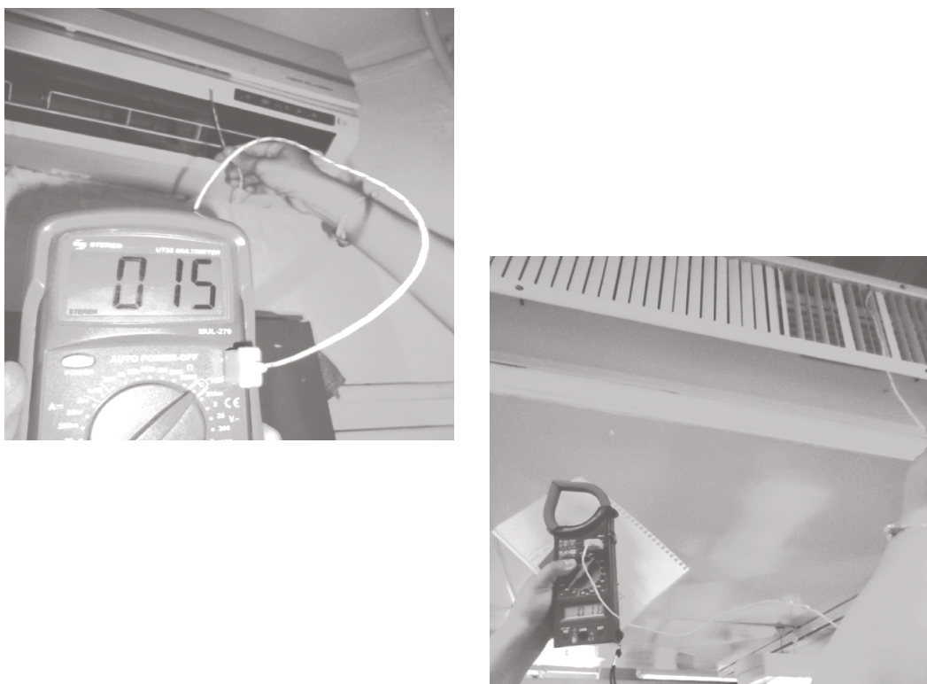
Figura 4. Valores de la temperatura del aire a las salidas de las rejillas de los equipos de AA.
