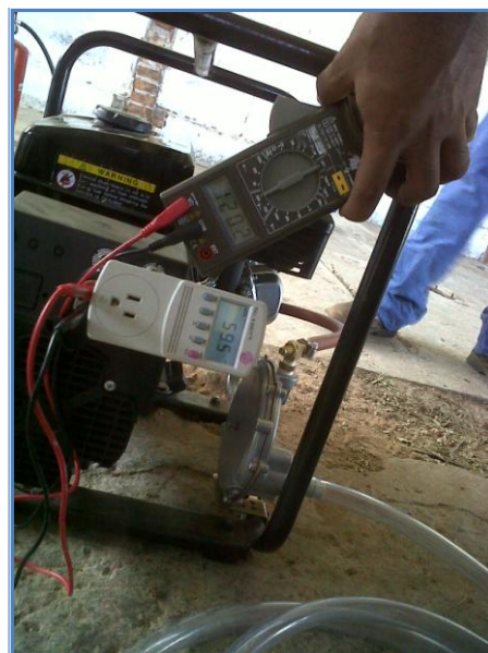
Fig. 6. Voltaje y frecuencia del motogenerador operado con biogás.
