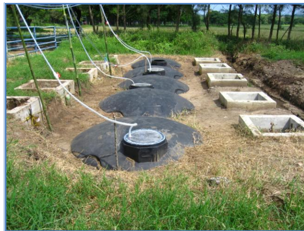
Fig. 1. Biodigestores de 5,000 L cada uno, a la izquierda los registros de entrada de las heces y a la derecha registro de salida del organilodo, las mangueras son la salida del biogás.
